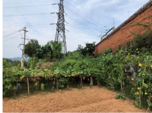
酿溪 110kV 变电站西侧厂界
