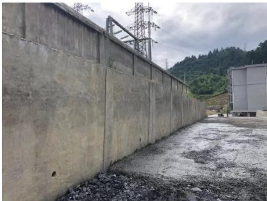
关峡 110kV 变电站西南侧
