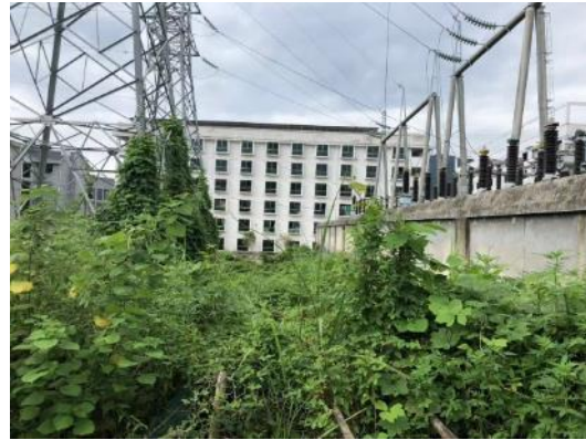
关峡 110kV 变电站东南侧
