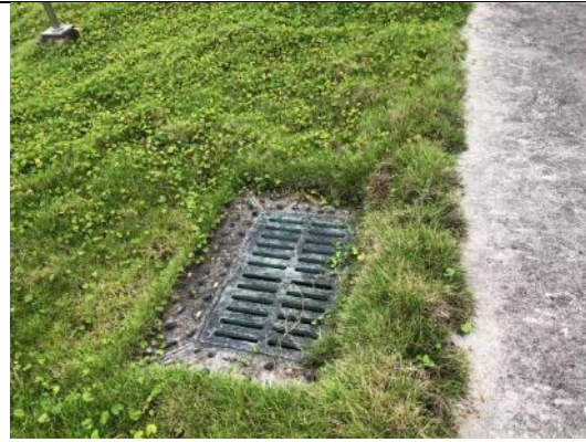
站内雨水下井
