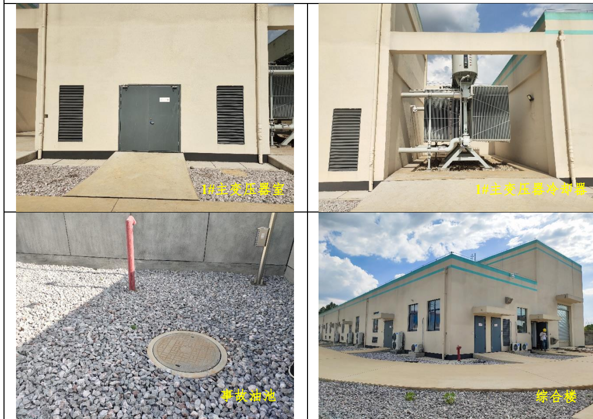
铸都（城北）110kV 变电站站内
