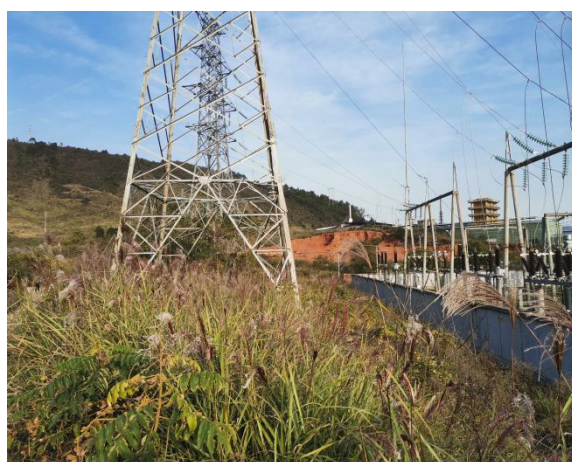
110kV 天子岭变间隔侧
