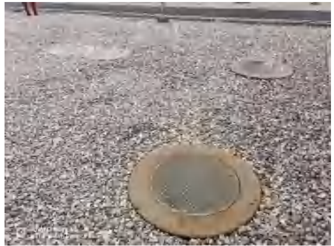
变电站污水处理设施
