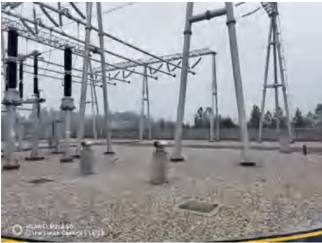
变电站事故油池
