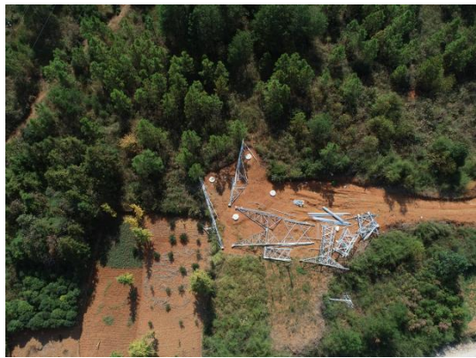
G2 塔基裸露未苫盖
