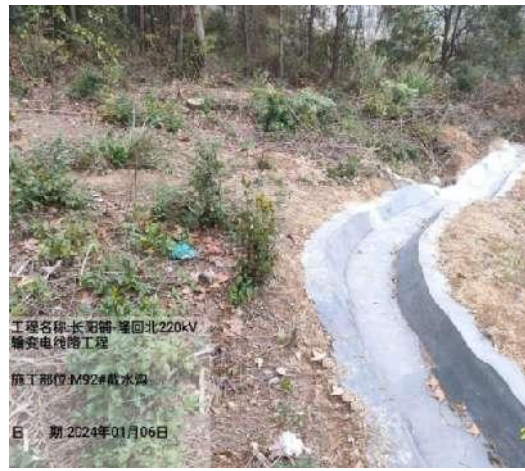
M92 塔基排水沟
