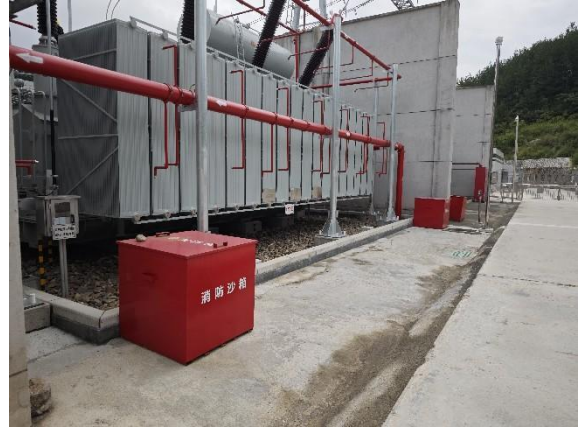
2号主变设备区
